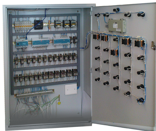
Фото 1. Щит управления котельной
