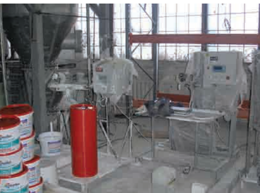
Дозировочные установки водного цеха
