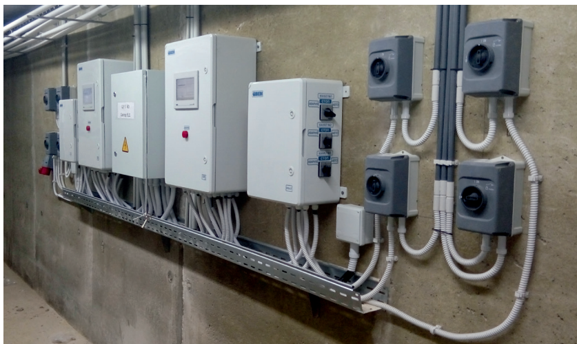
Смонтированные шкафы управления в свиноводческом комплексе «Смоленское поле»
